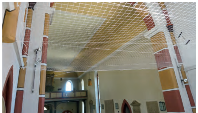
Fast so alt wie Heiligkreuz: die Michaelskirche in Hilsbach. Massive Schäden an Dach und Mauerwerk machen eine umfassende Sanierung nötig, ein Netz schützt vor herunterfallenden Teilen.
